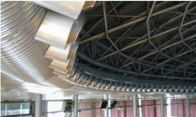
5 – Il canale di mandata dell'impianto di termoventilazione
